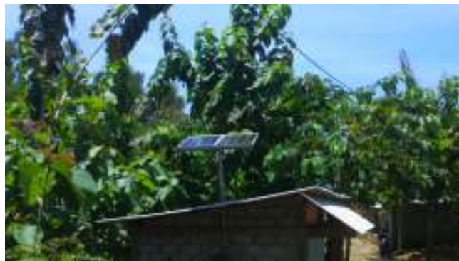
Setiap Usaha Kecil/Menengah Terdapat Panel Surya Sebagai Sumber Tenaga Untuk Penerangan
