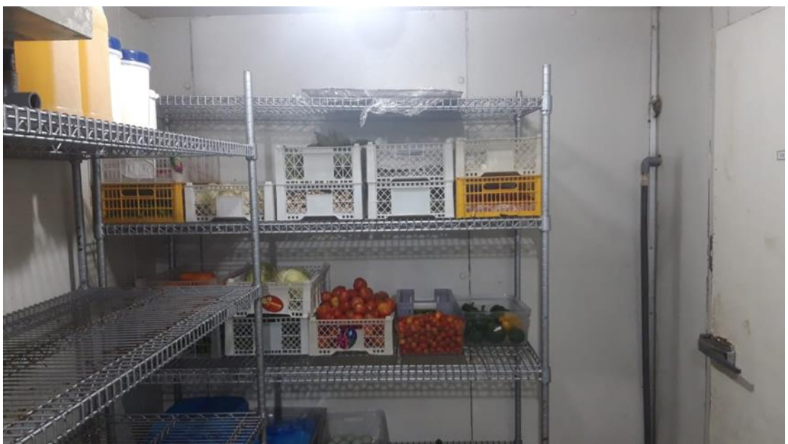
Banquet chiller dan Freezer
